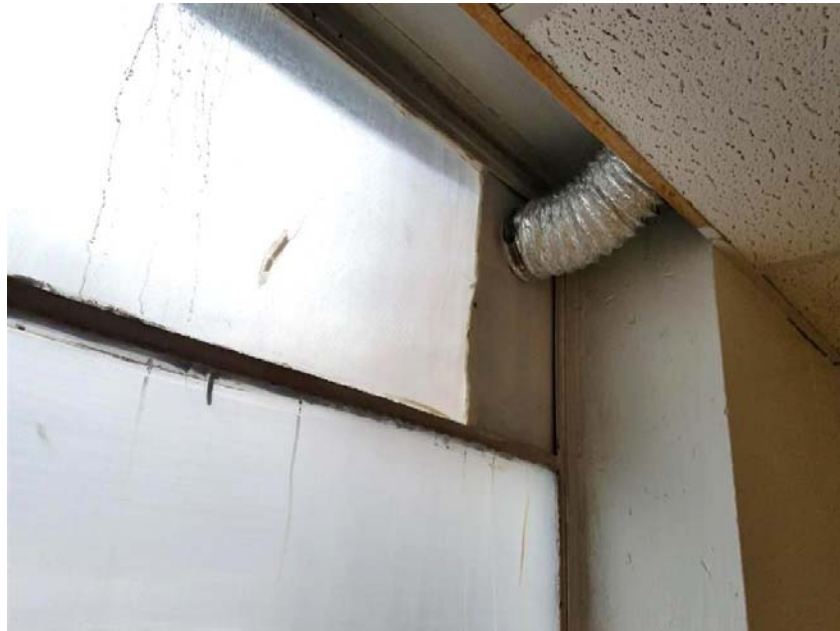
Toilet Room Exhaust Fan
