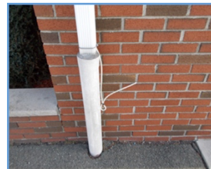
Tubulações de drenagem do telhado
